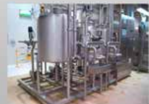
TRAITEMENT EAU DE SOURCE & MINÉRALE
